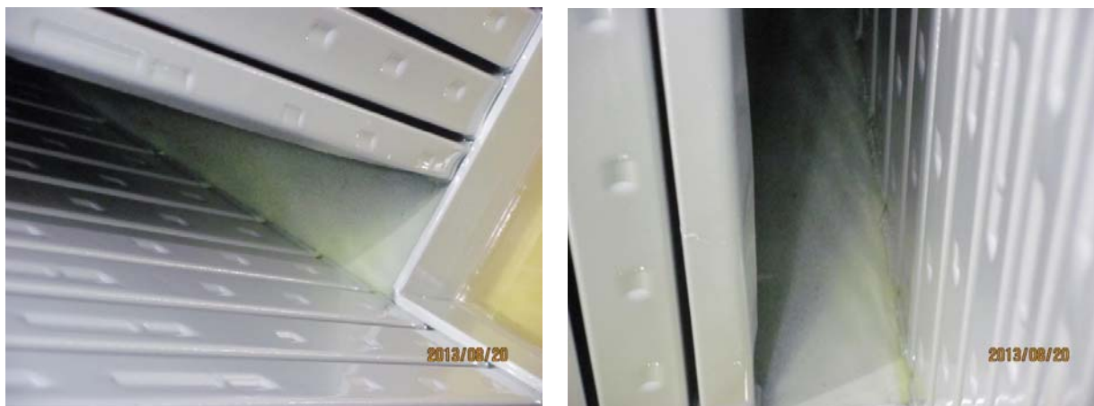
Slika 5. Zaostali penetrant u kotlu transformatora
